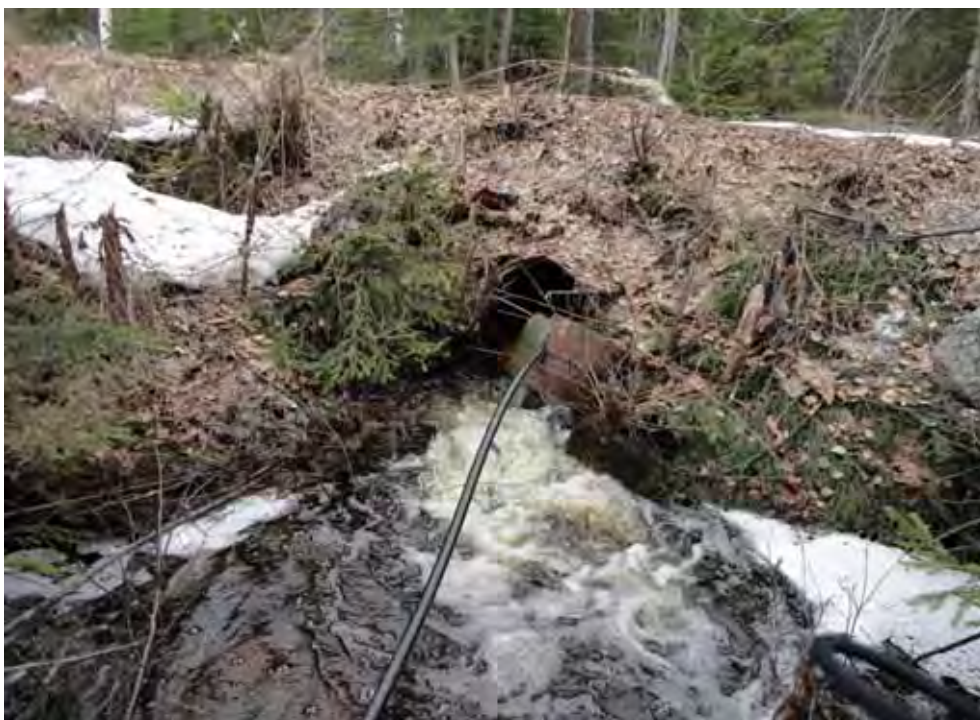
Figur 136. Vägtrumma mellan Svedtjärnen och Norbergfjärden som utgör definitivt vandringshinder.
