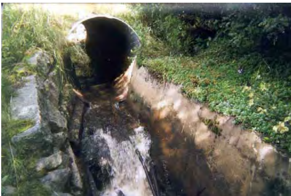
Figur 141. Vägtrumma i Bodtjärnsbäcken nedströms Ängasjön som utgör ett definitivt vandringshinder för fisk.
