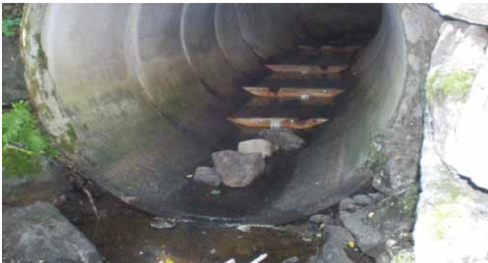
Figur 99. Hindrande vägtrumma i Garluöbäcken nedströms Blästatjärnarna med monterade strömdämpare. Fotot taget vid lågflöde.
