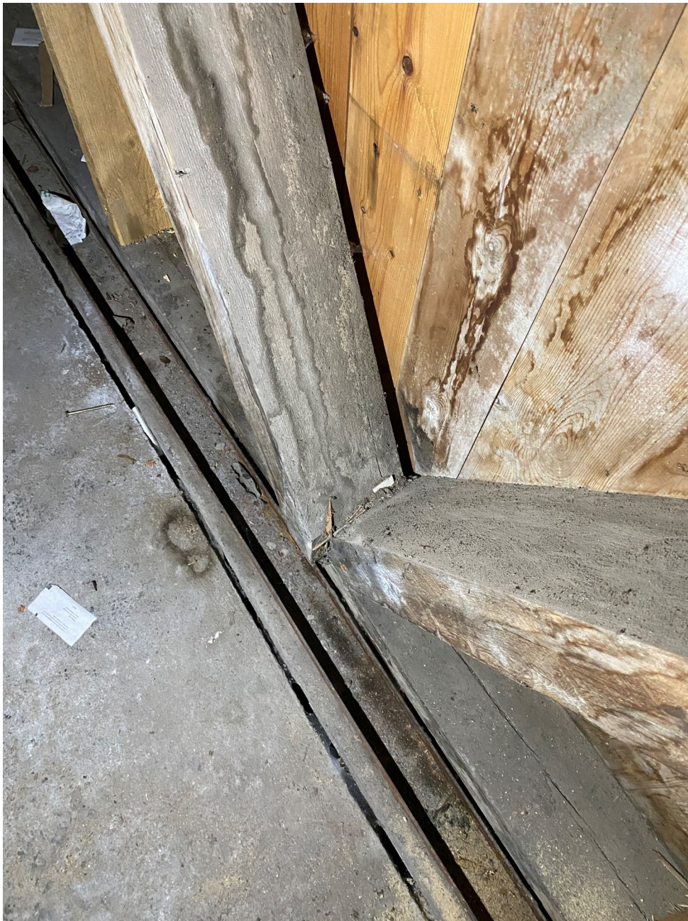
Förskjuten diagonal för stabilitet bör åtgärdas.
