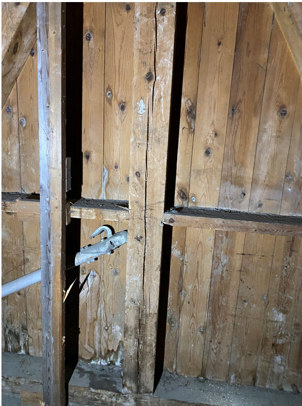
Sprickbildning i pelare samt fläckar.
