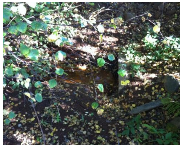
Figur 7. Bäckens inlopp till sågverkets dagvattennät. Trumma delvis igenfylld med sediment.
